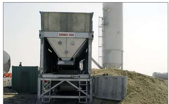
Abb. 2 Kompakte Bunkereinheit mit Rampe direkt an der Stahlkonstruktion
