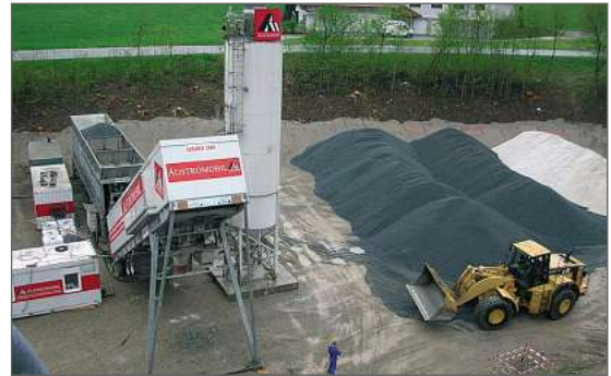
Abb. 1 EUROMIX Betonmischanlage mit Gesteinslager und Bunkereinheiten
