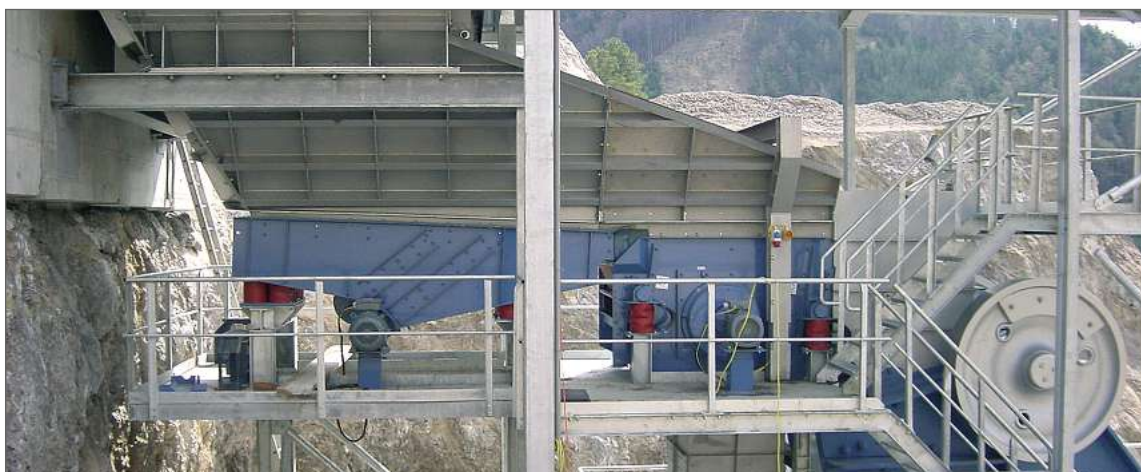
Abb. 1 Abzugsförderrinne mit Vorklassiersieb
