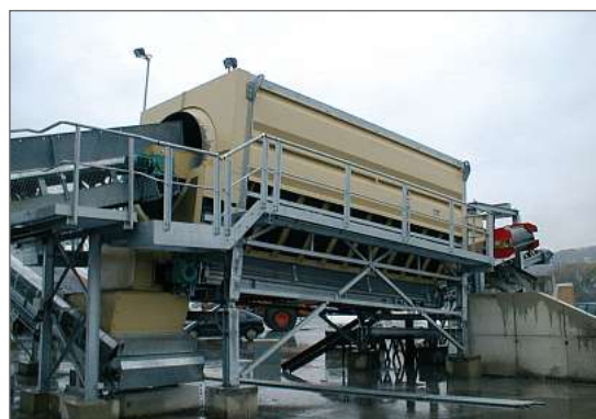
Abb. 3 Trommelsieb in einer Müllverbrennungsanlage
