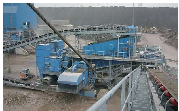
Abb. 4 Recyclinganlage für Asphalt und Beton
