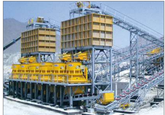
Abb. 1 Nachbrechanlage für Gabbro mit Kegelbrechern, Anlagenleistung 1000 t/h
