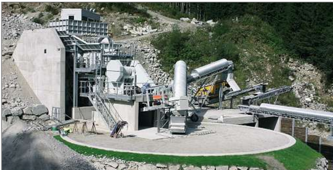
Abb. 3 Vorbrechanlage mit Backenbrecher in einem Granitsteinbruch, Nachzerkleinerung erfolgt mit Horizontal-Prallbrecher Typ SMR
