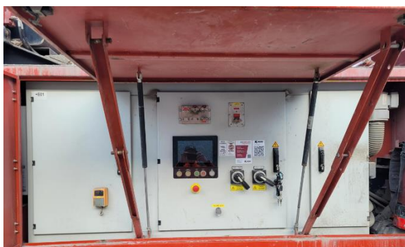
Schaltschrank / Control cabinet
